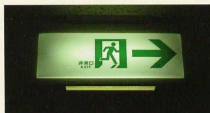
正常な表示板
