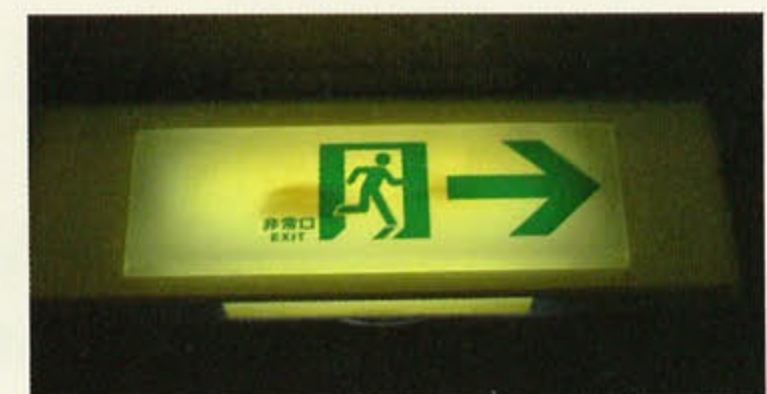
劣化した表示板の例
